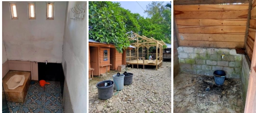
Gambar 3. Toilet dan Tempat Bilas Wisata Daya Tarik Kapalo Banda
