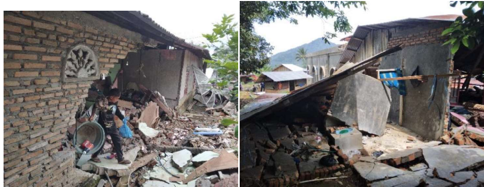
Gambar 2. Kondisi Bangunan Pasca Gempa Kab. Pasaman Barat (Sumber: Gambar (a) dan (b) diperoleh dari Tim Asesor Departemen Teknik Sipil UNP)
