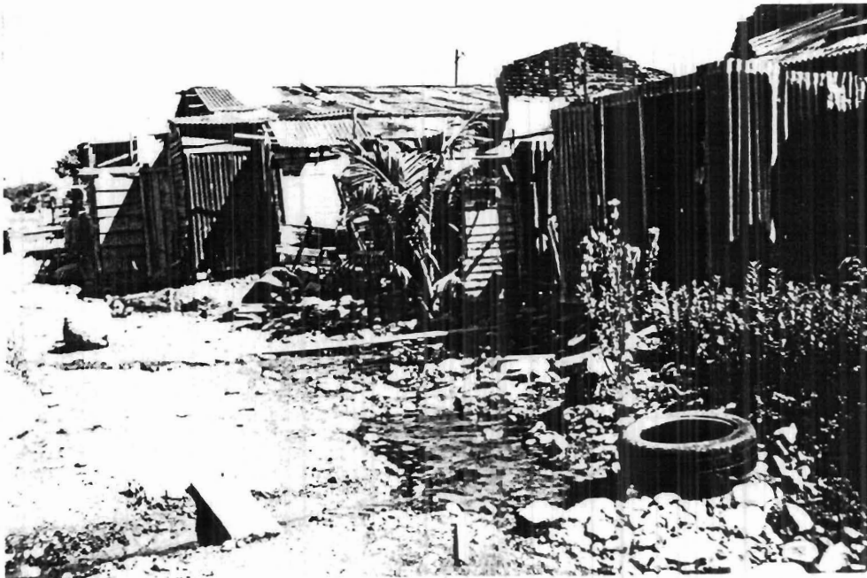
Gambar 11. Permukiman yang Rusak oleh Gelombang Pantai
