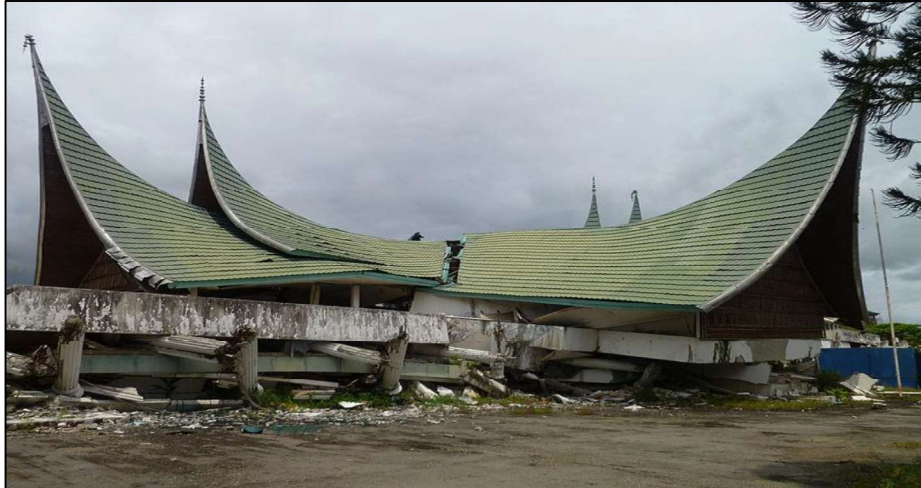
Gambar 2. Salah Satu Bangunan Rusak Akibat Gempa (Sumber: Mahfus, 2021)
