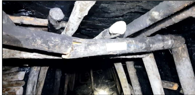
Gambar 1. Penyangga Patah pada Lubang D-12
