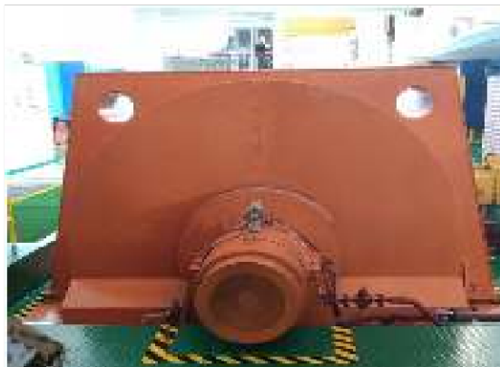
Gambar 2.12 Generator PLTA Batang Agam
