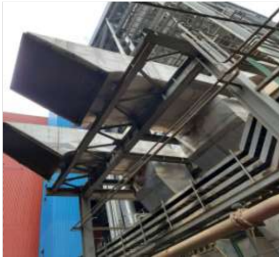
Gambar 7 : Inlet Secondary Air Fan
