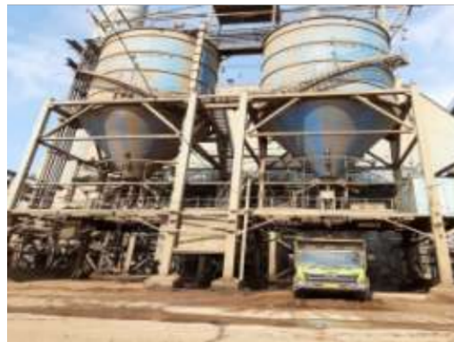
Gambar 22. Fly Ash Silo
