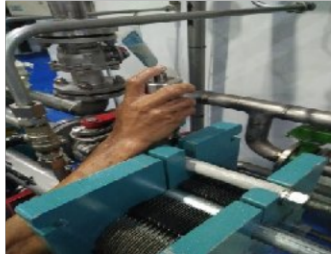
Gambar 4.2.11 pengeluaran udara pada Plate Heat Exchanger
