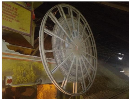
Gambar 26. Cable Drums (Sumber : Dokumentasi Pribadi)
