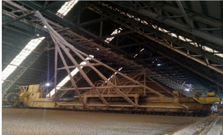
Gambar 6. Bridge Scraper (Sumber : Dokumentasi Pribadi)
