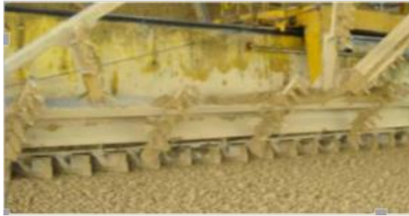
Gambar 14. Scraper Chain (Sumber : Dokumentasi Pribadi)
