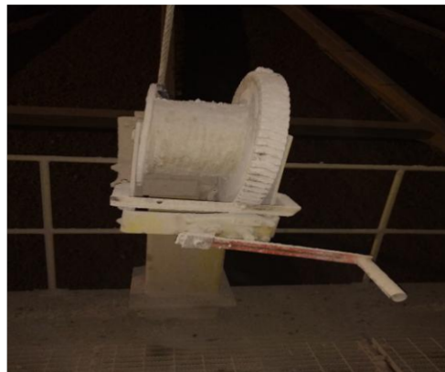
Gambar 11. Hoisting Winch (Sumber : Dokumentasi Pribadi)
