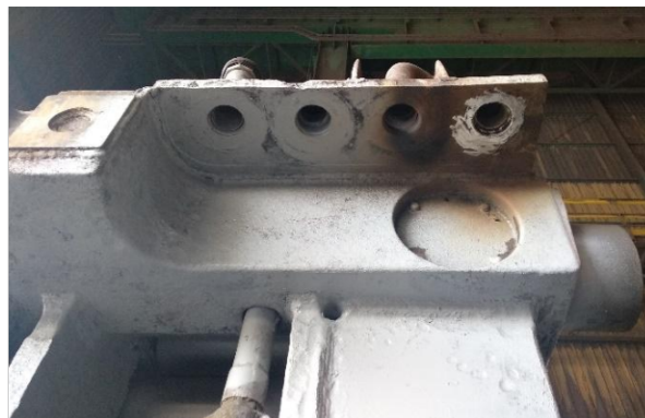
Gambar 39. Saluran udara dan air yang terpasang di bagian inner bender
