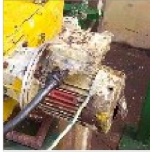
gambar 4.3 motor listrik pompa
