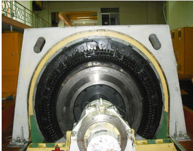
Gambar 1.12. Generator pada PLTA Batang Agam
