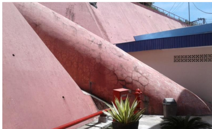
Gambar 1.8. Penstock PLTA Batang Agam
