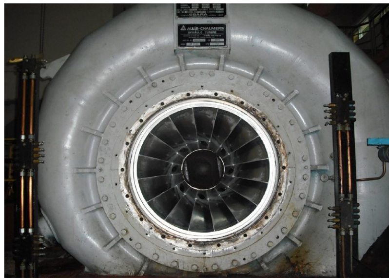
Gambar 1.11. Turbin Hidraulik PLTA Batang Agam tampak depan
