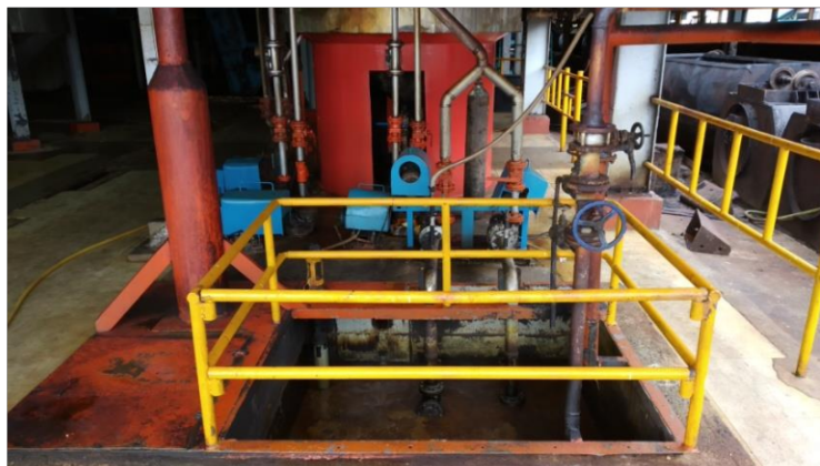
Gambar 2.18 Reclaim Oil Tank (penampungan Minyak Kutipan)
