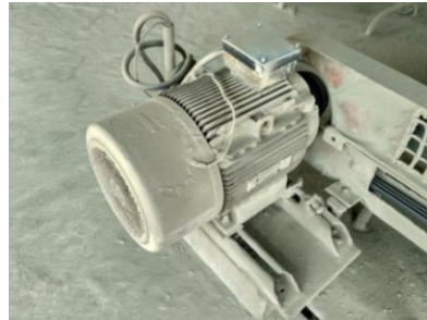
Gambar 4.2 Motor Penggerak (Sumber: Bagian Area Jet Pulse filter, air sluice, apron conveyor, Indarung V PT. Semen Padang)
