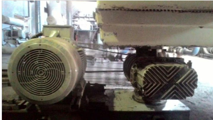
Gambar 4.2 Motor Rotary Blower Sumber: Bagian Area Rotary Blower dan Coriolis Pabrik Indarung V PT. Semen Padang
