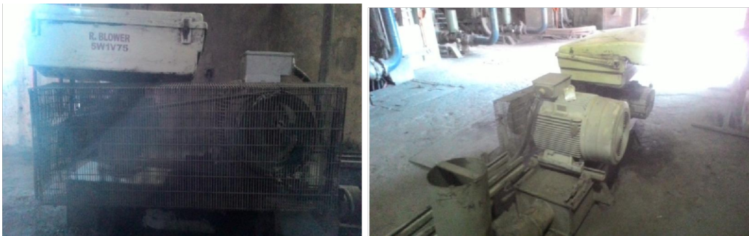
Gambar 4.1 Rotary Blower Sumber: Bagian Area Rotary Blower dan Coriolis Pabrik Indarung V PT. Semen Padang
