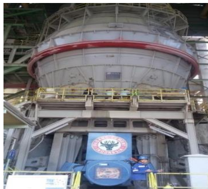
Gambar 7. Raw Mill Pabrik Indarung VI (Sumber : Dokumentasi Pribadi, 2023)
