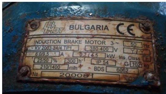
Gambar 21. Nameplate motor induksi 3 fasa (Sumber: Dokumentasi PLI)
