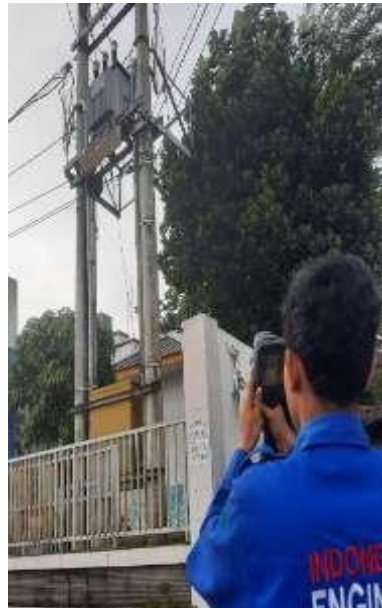
Lampiran 5 Pengecekan suhu Trafo menggunakan Thermovisi
