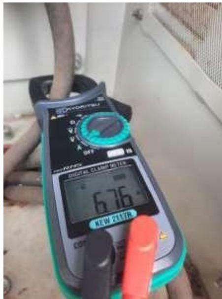
Lampiran 4 Pengecekan arus pada Gardu
