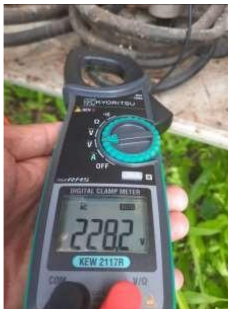
Gambar 4.20 Pengukuran Tegangan Fasa -Netral
