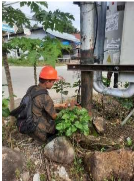
Gambar 4.18 Pengukuran pentanahan gardu
