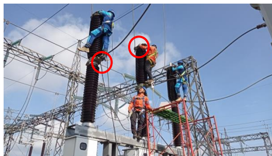
Gambar 22. Terminal Pengujian Tahanan Kontak PMT
