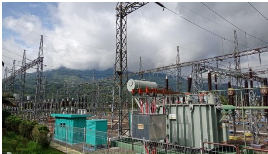
Gambar 3. Switchyard Gardu Induk Padang Luar
