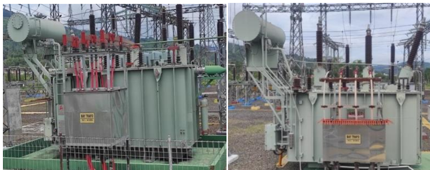
Gambar 4. Transformator Daya 60 MVA dan 30 MVA
