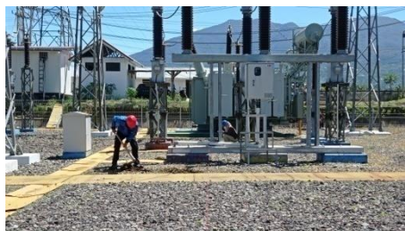
Gambar 7. Pengujian Pentanahan Komponen Bay Trafo 2
