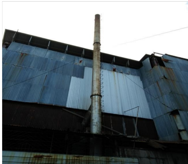
Gambar 30. Chimney ( cerobong asap ) Sumber PT Jaya Sentrikon Indonesia
