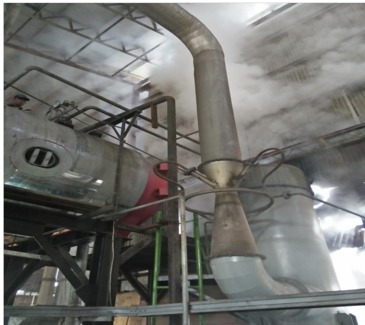
Gambar 37. Penyetingan Safety Valve Sumber PT. Jaya Sentrikon Indonesia
