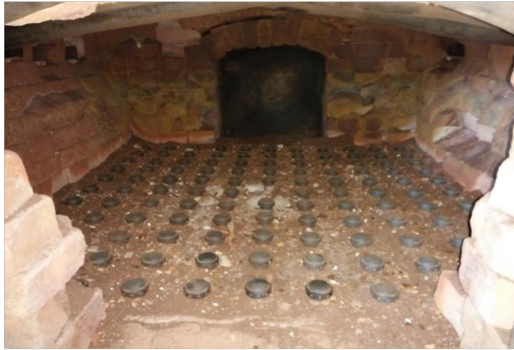
Gambar 33. Dinding ruang bakar Sumber PT Jaya Sentrikon Indonesia
