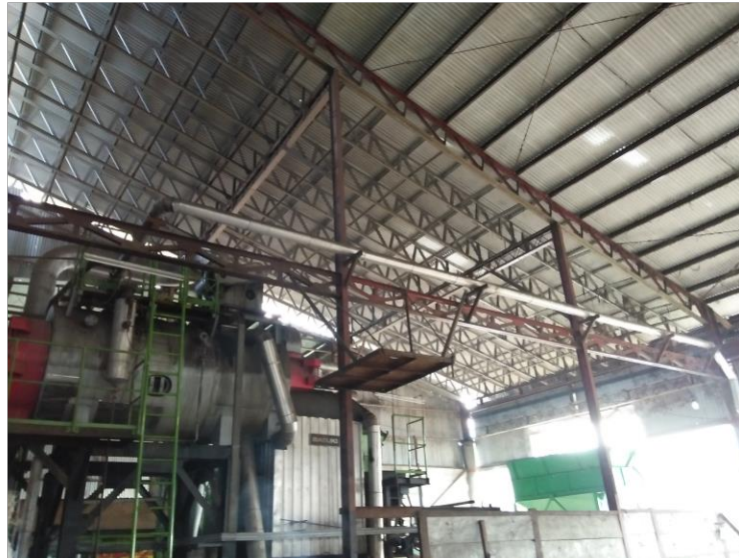
Gambar 23. Boiler Basuki 2.2188 Sumber . PT Jaya Sentrikon Indonesia
