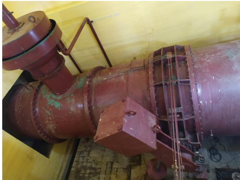
Gambar 10. Valve Chamber (Katup Utama)
