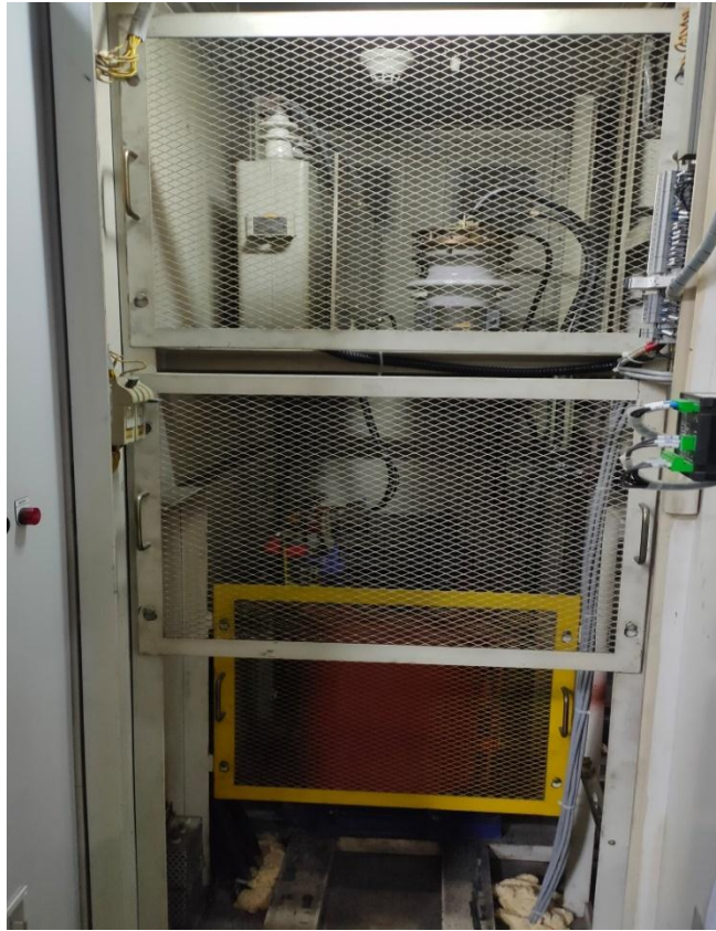
Gambar 37. Trafo Eksitasi PLTA Batang Agam
