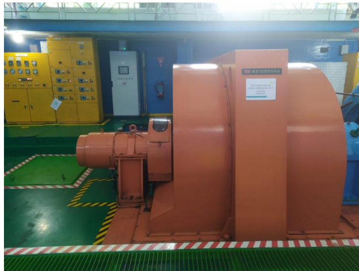
Gambar 18. Generator PLTA Batang Agam
