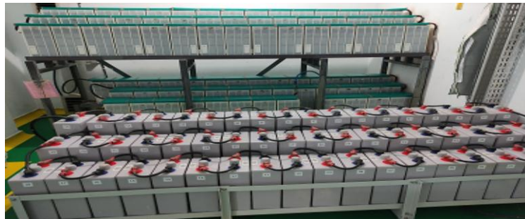
Gambar 39. Ruang Baterai PLTA Batang Agam
