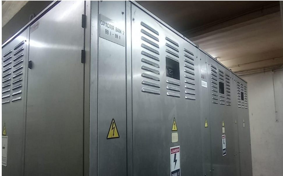
Kapasitor Bank Tampak Luar
