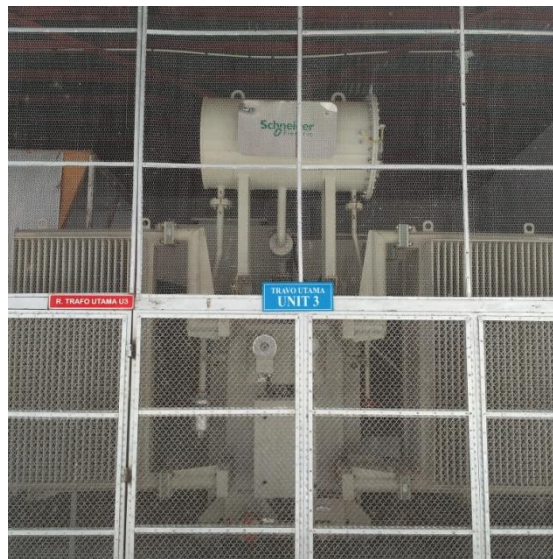
Gambar 2.9 Transformator Unit 3 PLTA Batang Agam
