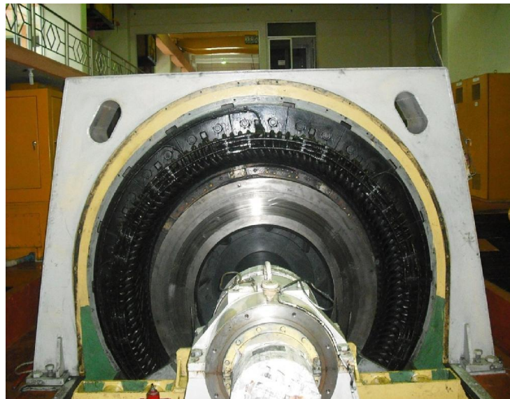
Gambar 2.8 Generator PLTA Batang Agam
