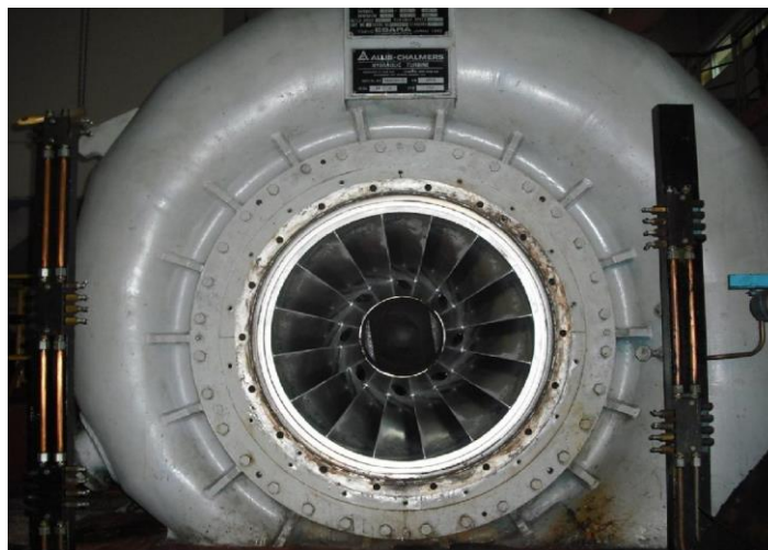
Gambar 2.7 Turbin Hidrolik PLTA Batang Agam
