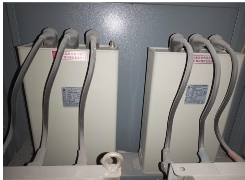
Gambar 16. Kapasitor low voltage
