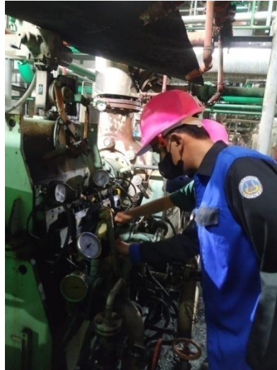
Gambar 5. Proses cleaning pada pressure transmitter
