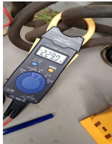
Gambar 11. Pengukuran tegangan PHB-TR
