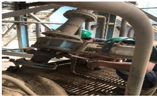
Gambar 4. Kegiatan perbaikan pada transporter yang bocor (Sumber : Pribadi)
