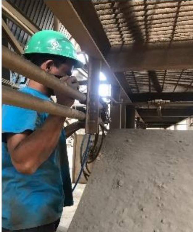
a. Kegiatan Perbaikan selang Transporter yang bocor
