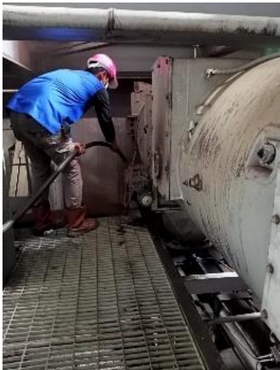
b. Kegiatan Pengecekan pada kabel coal feeder
