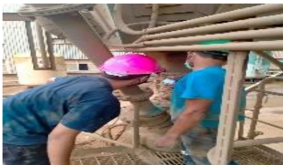
Gambar 2. Proses kegiatan perawatan pada valve control transporter yang bocor
