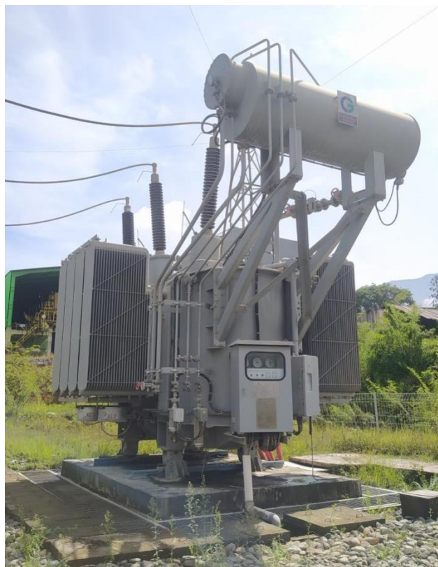
Gambar 4. 1 Main Transformator 8 Gardu Induk PT. Semen Padang
