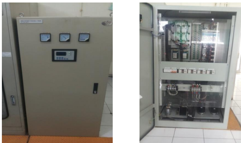
Gambar 4.10 Rectifier 110 V DC
