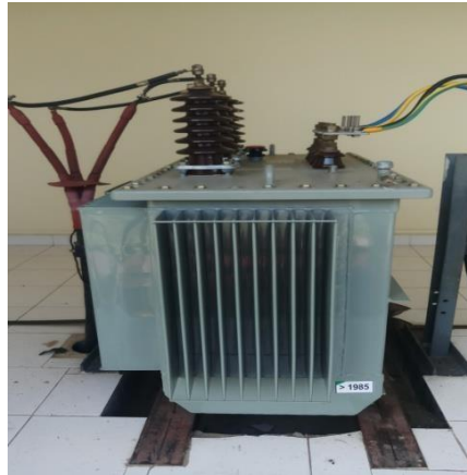
Gambar 4.4 Pendingin Trafo Pemakaian Sendiri Gardu Induk Solok
