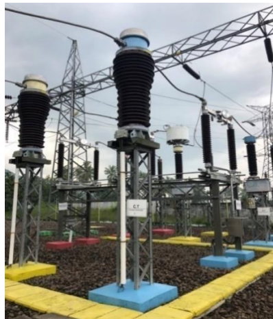
Gambar 3.11 Transformator Arus Gardu Induk Solok
