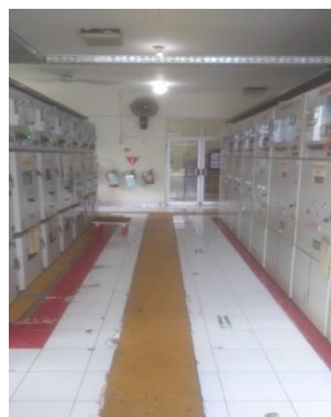
Gambar 3.14Cubicle Gardu Induk Solok
