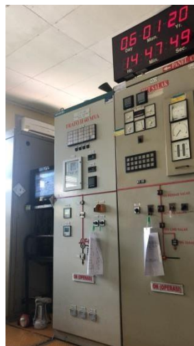
Gambar 3.15 Panel Kontrol Gardu Induk Solok
