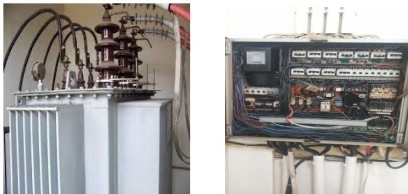
Gambar 4.3 Trafo Pemakaian Sendiri dan Panel Distribusi AC
