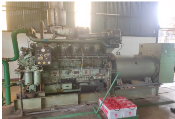
Gambar 2. 3 Generator magna MAX dengan kapasitas 1000 KW
