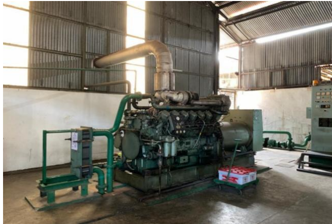
Gambar 8. Generator Yanmar di PT. Lembah Karet Padang (Dokumentasi Pribadi)
