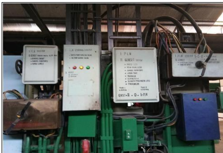
Panel Listrik PLN
