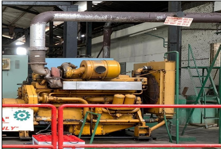
Generator Caterpillar sebagai Generator Cadangan
