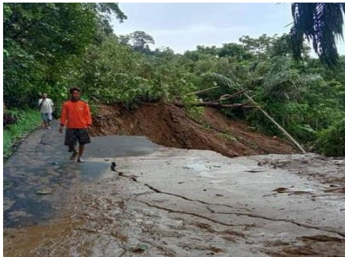
Gambar 25. Runtuhan tanah/tanah amblas yang terjadi di Nagari Kajai (Pasca Gempa, Nagari Kajai Pasbar Dikepung Longsor 2022)
