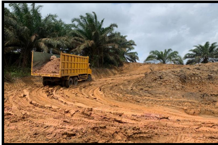
Gambar 20. Grade Jalan yang Tinggi
