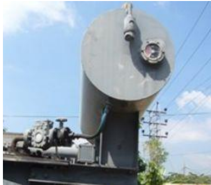
Gambar 14. Konservator Minyak Trafo
