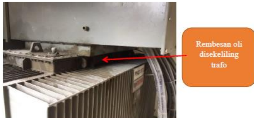
Gambar 22. Kebocoran pada seal bushing primer dan sekunder
