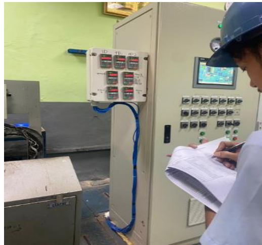
Gambar 2. 12 Pengecekan Arus dan Tegangan Pada Panel
