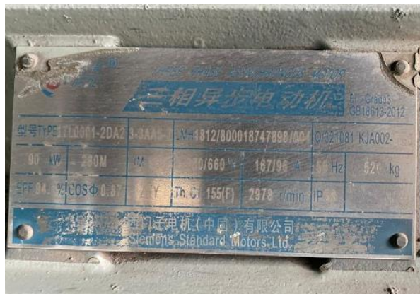
Gambar 2. 27 Nameplate Motor FD FAN 90 kW
