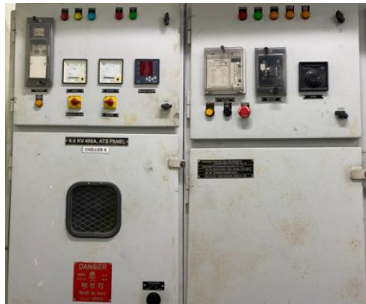
Gambar 2. 10 Panel Starter Auto Transformator chiller (Sumber: Dokumentasi Pribadi)
