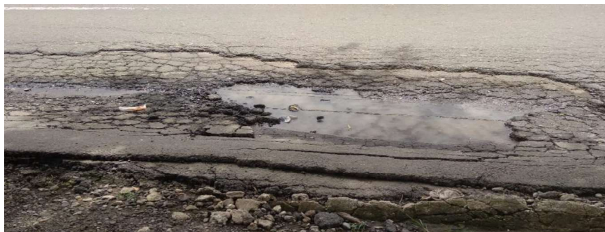
Gambar 3. Kerusakan jalan Pada Ruas jalan Raya Kuranji Sumber: Dokumentasi Febrianka, 2022
