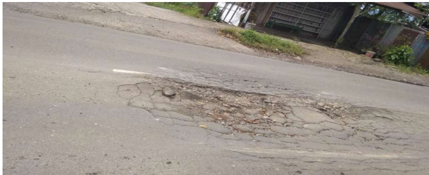
Gambar 2. Kerusakan jalan Pada Ruas jalan Raya Kuranji Sumber: Dokumentasi Febrianka, 2022
