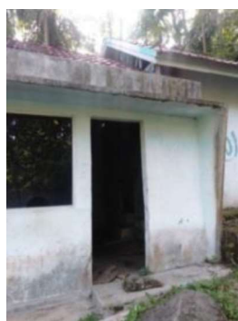
Gambar 3. Toilet yang sudah rusak
