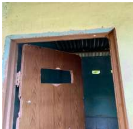
Gambar 3. Toilet dalam keadaan berlubang
