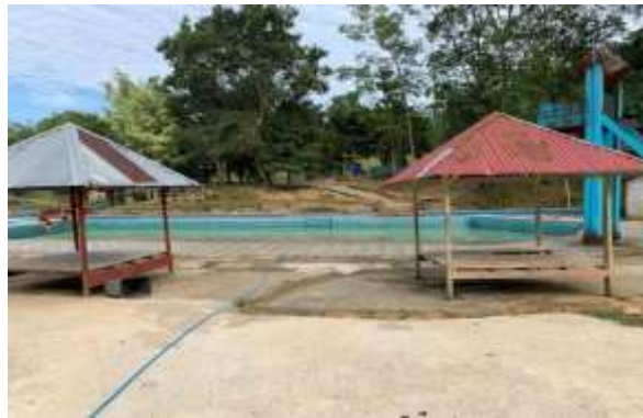
Gambar 2. Gazebo yang sudah bolong
