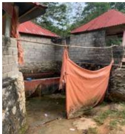
Gambar 5. Kamar bilas tidak tertutup
