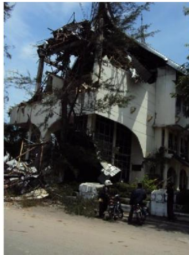
Gambar 2. Kerusakan Bangunan Pasca Gempa 2009 Sumber: INFO UNP, 2019
