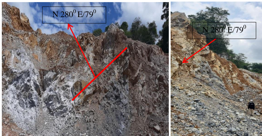
Gambar 1. Kondisi Lereng Pada Area Blok Puncak II CV. Tekad Jaya
