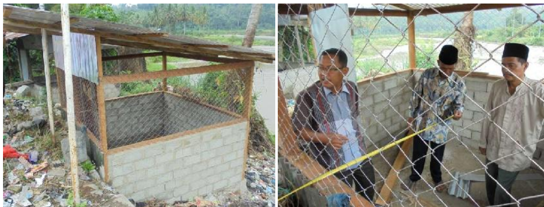
Gambar 4. Rumah/pondok peletakan mesin pompa
