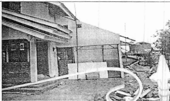
Bangunan rumah di kec Koto Tangah turun akibat liquifaksi
